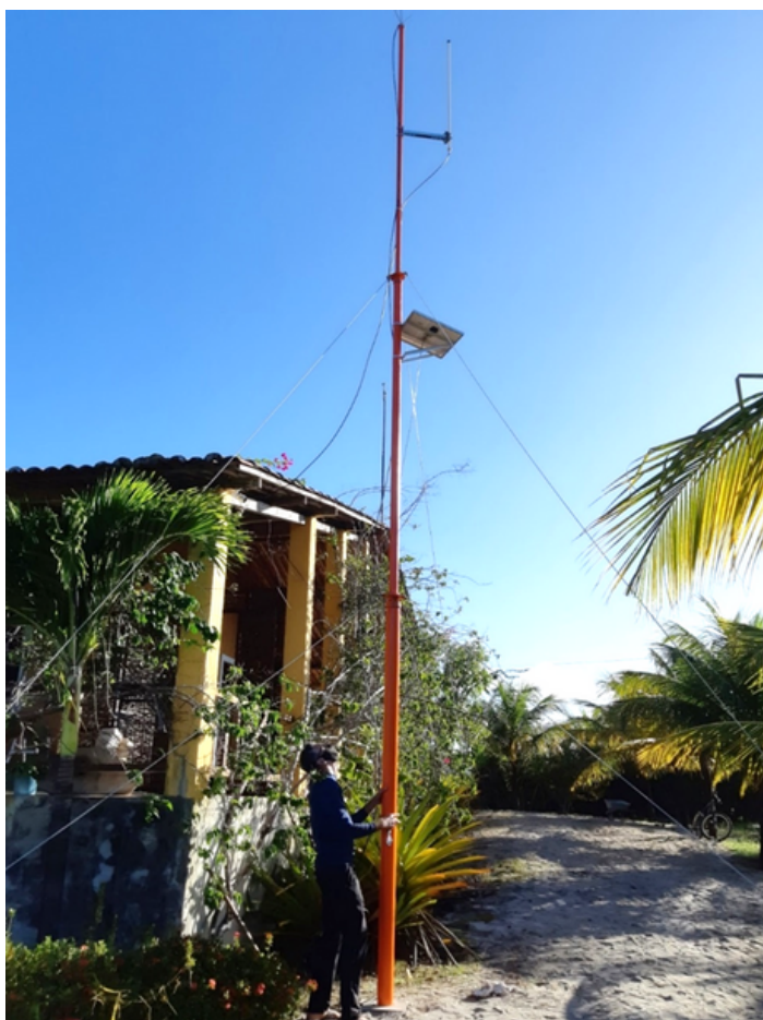
Figura 2.4.1: Torre de transmissão instalada com a sua estrutura de fixação.
