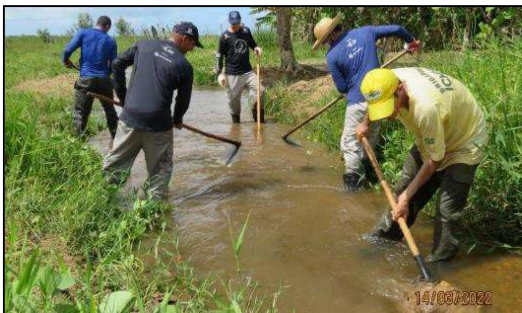
Figura 1.2.4.18: Retirada de sedimento do riacho Manimbu a jusante para facilitar o escoamento da água.
